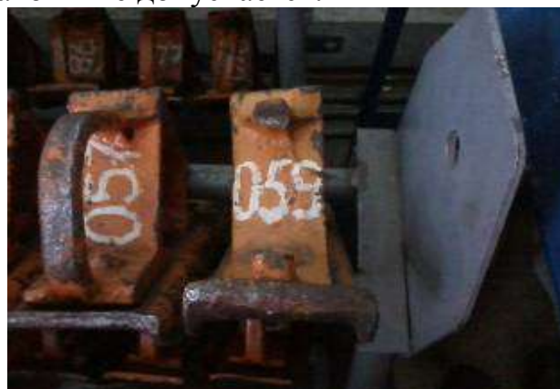
отсутствие или трещина в рукоятке
