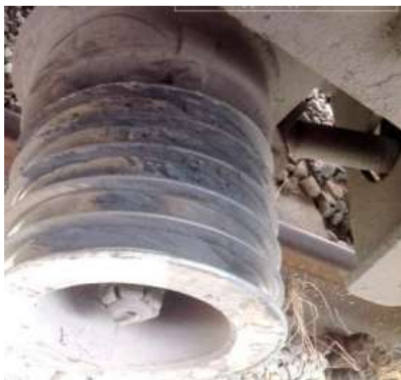
отсутствие ремней приводов генераторов, следы налипания ремней вследствие нагрева и проскальзывания
