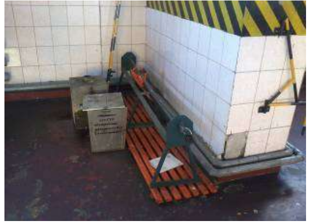
трещина, скол, деформация ПОДОШВЫ
