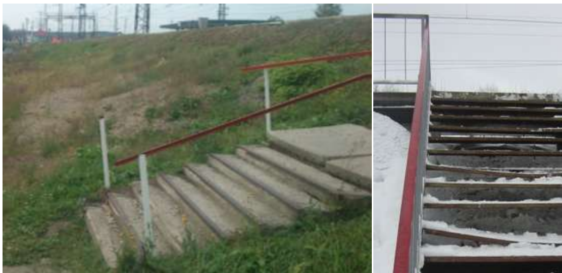
Отсутствие элементов поручней, металлических ограждений посадочных платформ и подходов к ним, уголков обрамления, ведущих к возможности травмирования людей
