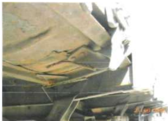
Прогиб крышки люка
