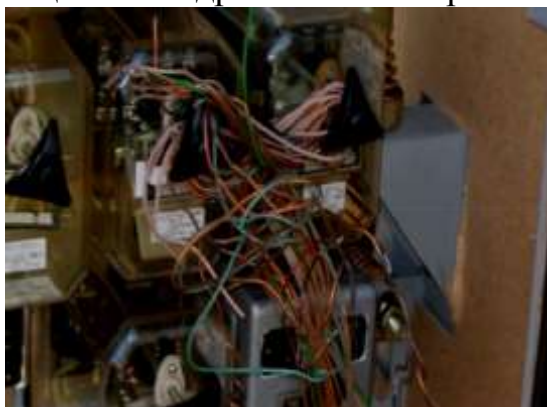
Не упорядочен монтаж проводов релейном шкафу
