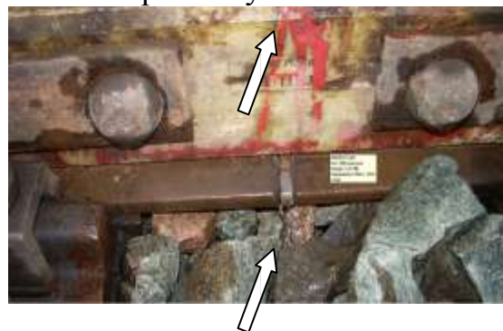
Отсутствие изоляции в держателе троса и наличие стружки приводит к короткому замыканию
