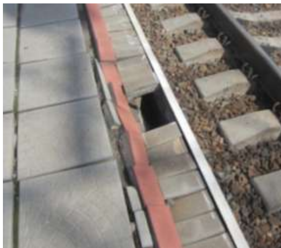
Разрушения посадочных платформ, нарушение целостности, приводящая к нарушению габарита платформы, травмированию граждан при посадке/высадке в поезда
