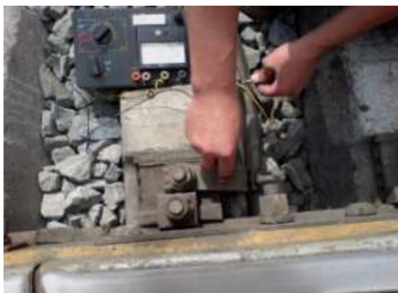
Измерение кронштейн – дроссельная перемычка
